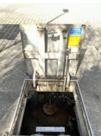
Solebohrung mit Pumpe
